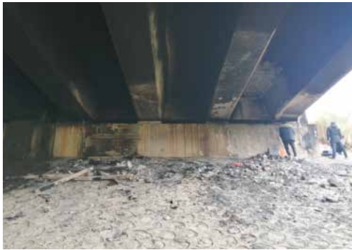
图2 火灾后桥底现状
