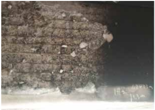
图4 主梁腹板钢筋外露
