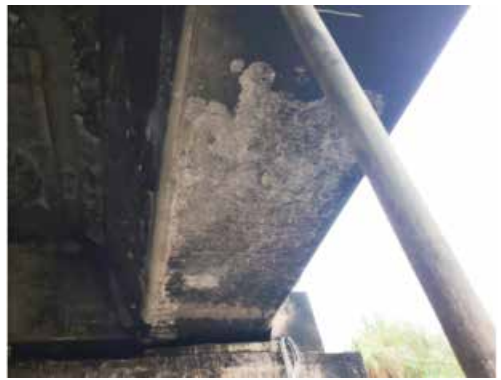
图3 主梁底板剥落、露筋
